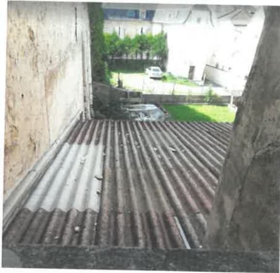
Vue depuis le 20 grande rue : cœur d'îlot sans fonction et bâtiment dégradé (Constat de chutes de pierres sur la toiture ondulée)
