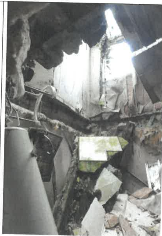
Exemple effondrement intérieur immeuble sur cour
